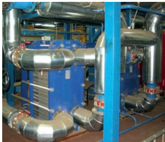
Автоматизированная газовая модульная котельная №22 мощностью 13,42 МВт г. Арзамас
