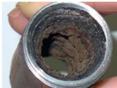
Отложения на внутренней поверхности трубы конвективной части водогрейного котла КВГМ-100
