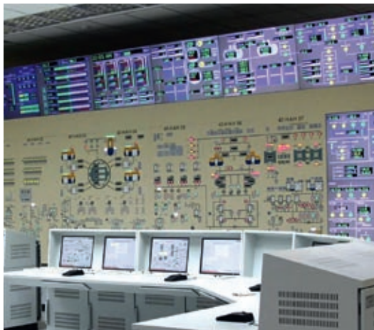
Полномасштабный тренажер на четвертом энергоблоке Калининской АЭС
