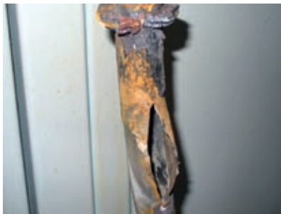
Разрыв трубы конвективной части водогрейного котла КВГМ-100
