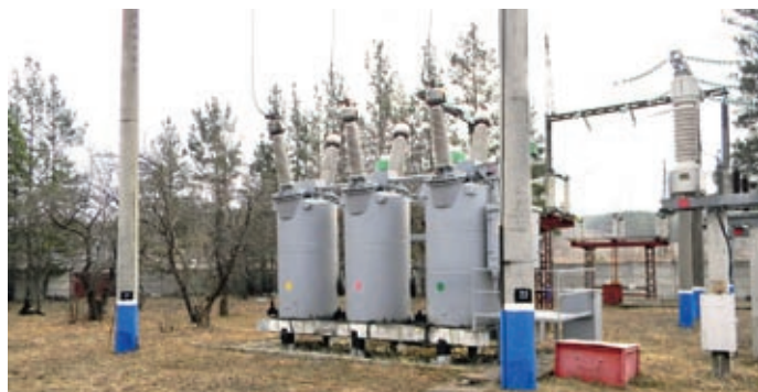
ПС 110/35/10 кВ «Ночка» до капитального ремонта
